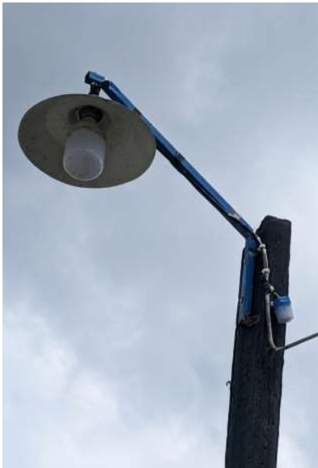
Gambar 9. Lampu LED, fitting, dan photocell pada sistem PJU.
