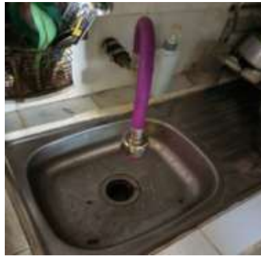
Gambar 10 Temuan ketidaksesuaian Area Wastafel
